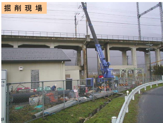
濁水処理設備
